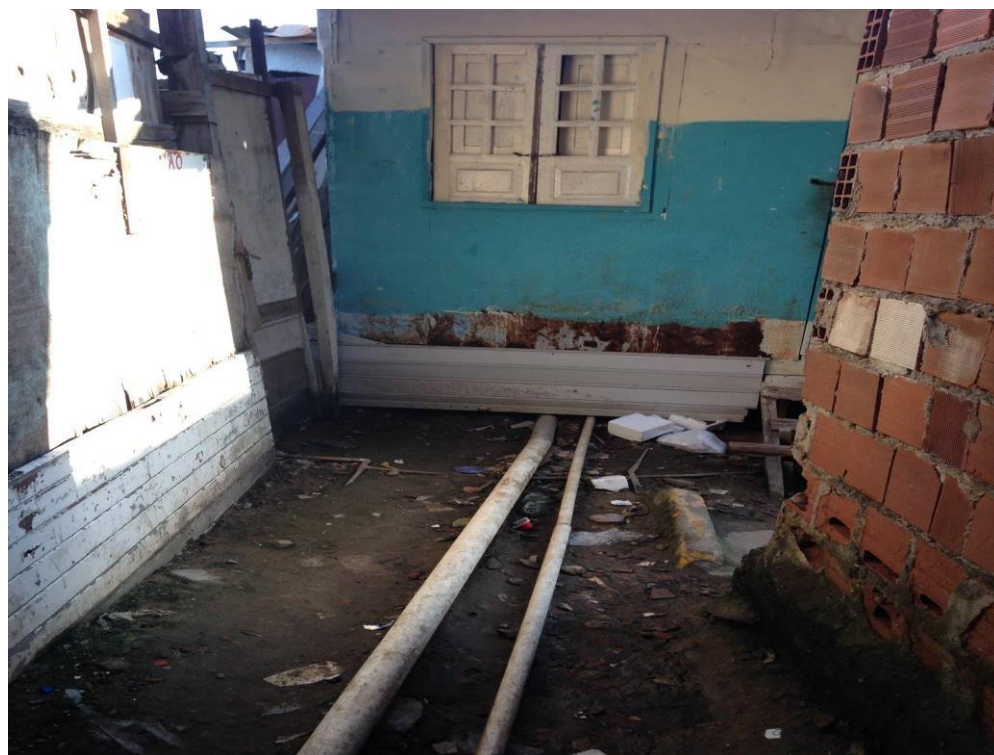
Figura 30 – Sistema de escoamento de esgoto na comunidade Roque Santeiro na ZEIS Coelhos
