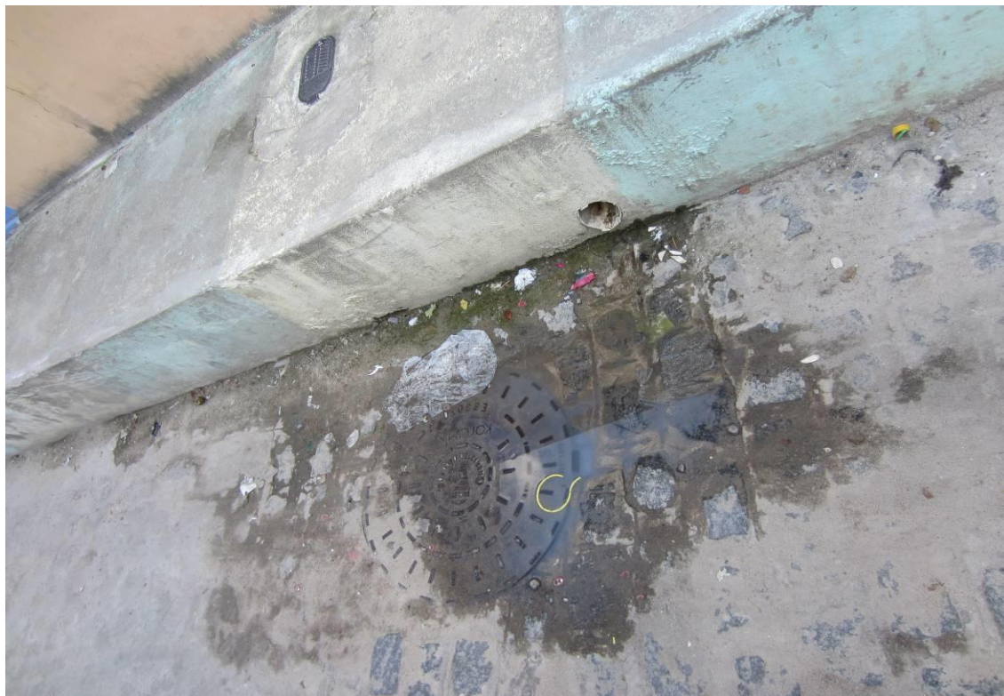
Figura 24 – Vazamento de esgoto na rua principal da ZEIS Mangueira da Torre
