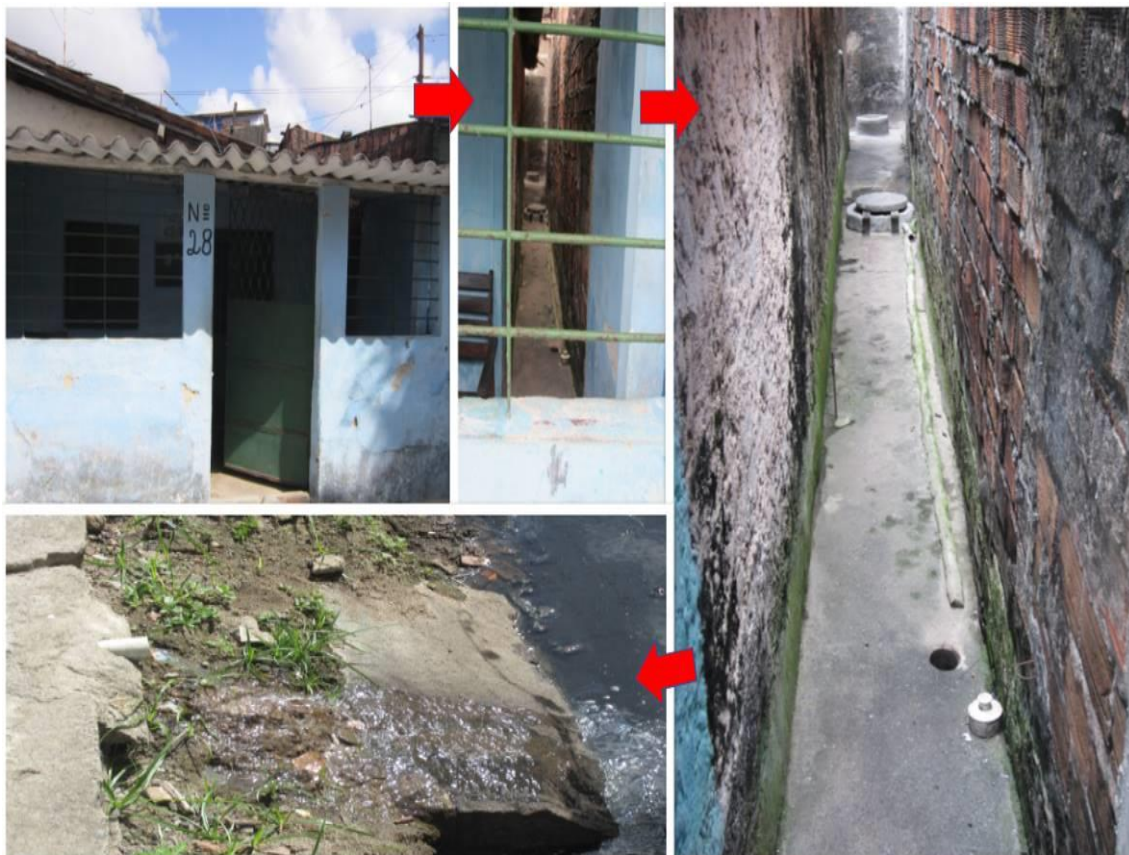
Figura 19 – Solução local (extravasor) para lidar com problemas operacionais na rede de coleta de esgoto na ZEIS Mangueira
